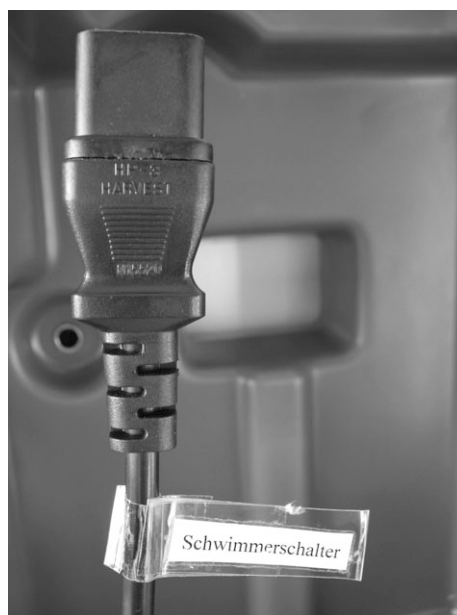
Bild 8 Elektrischer Anschluss der Box 15
